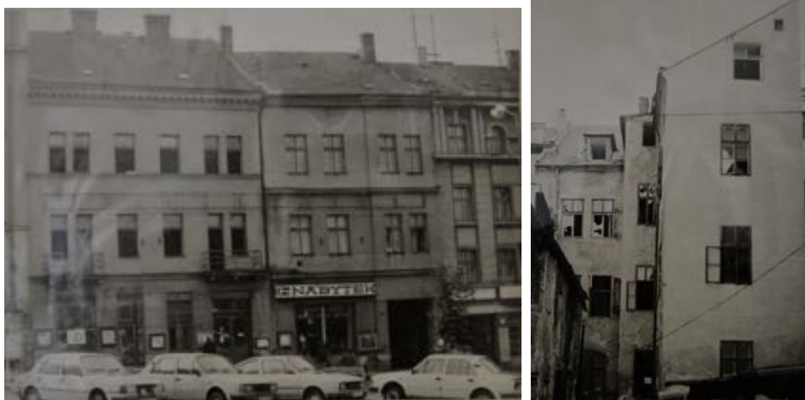
Fotodokumentace stavu domu, hlavní a dvorní průčelí z konce 80. let 20. století, archiv Stavebního úřadu v Turnově.
