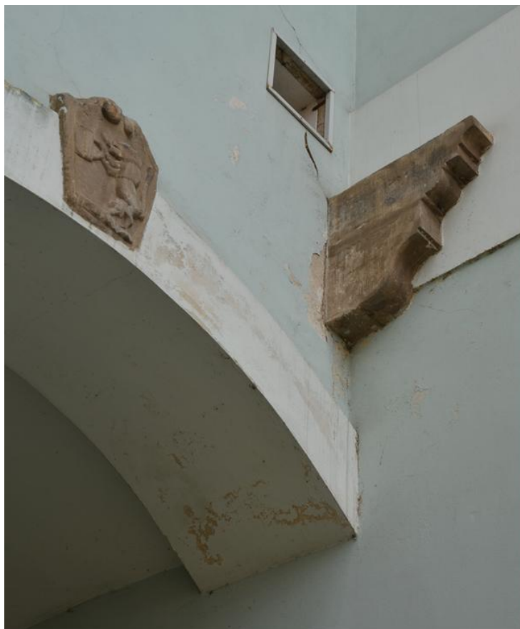
Detail klenáku na záklenku průjezdu a krakorce po pavlači u dvorního průčelí, foto IP 2013.
