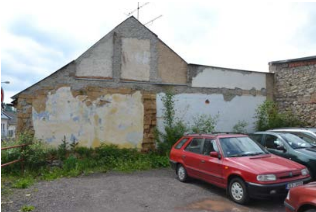
Relikty domu č. p. 6 po demolici, jižní obvodové zdivo přisedající k č. p. 7, foto IP 2013.
