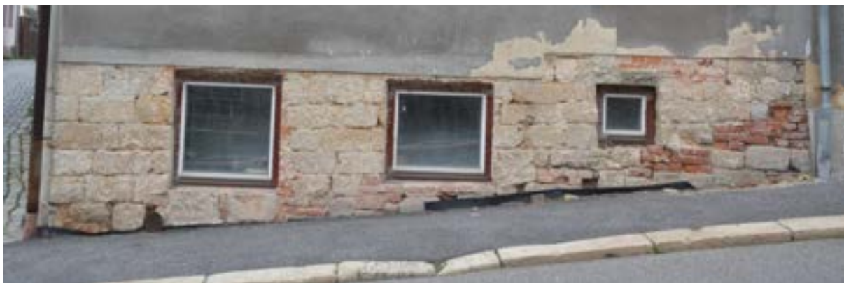
Dům č. p. 412, detail otlučené soklové části hlavního východního průčelí, foto IP 2013.
